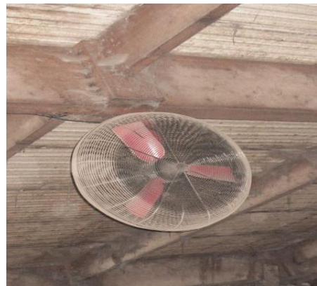
Kuva 6 Tuulettin katossa tehostamassa ilman kiertoa
