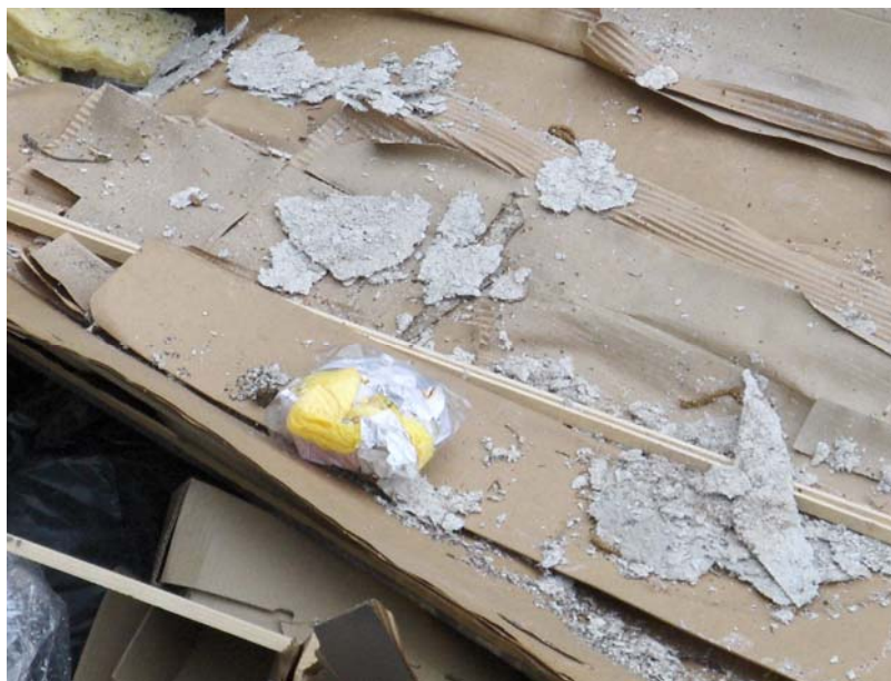
Kuva 1. Asbestijätettä tuotu luvatta työmaan sekajätelavalle
