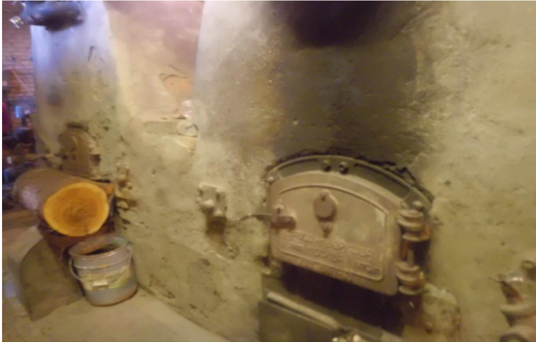
Kuva 7. Lämpölaitoksen nykyiset kattilat
