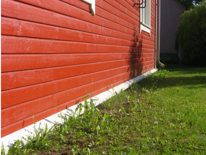
Kuva 3. Maanpinta kallistuu rakennukseen päin ja se on liian lähellä perusmuurin yläpintaa.
