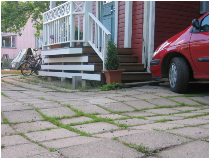
Kuva 4. Etupihalla sijaitsevan parkkialueen maa-aines routii.
