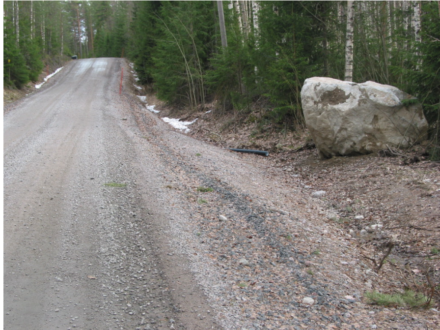
Kuva 5. Päiväjärven yt, Teisko. Pitkään haitannut routakohta paljastui isoksi kivilohkareeksi. Huomaa salaojaputki, joka kuivattaa tien runkoa. (Kuva R. Kreutzer)
