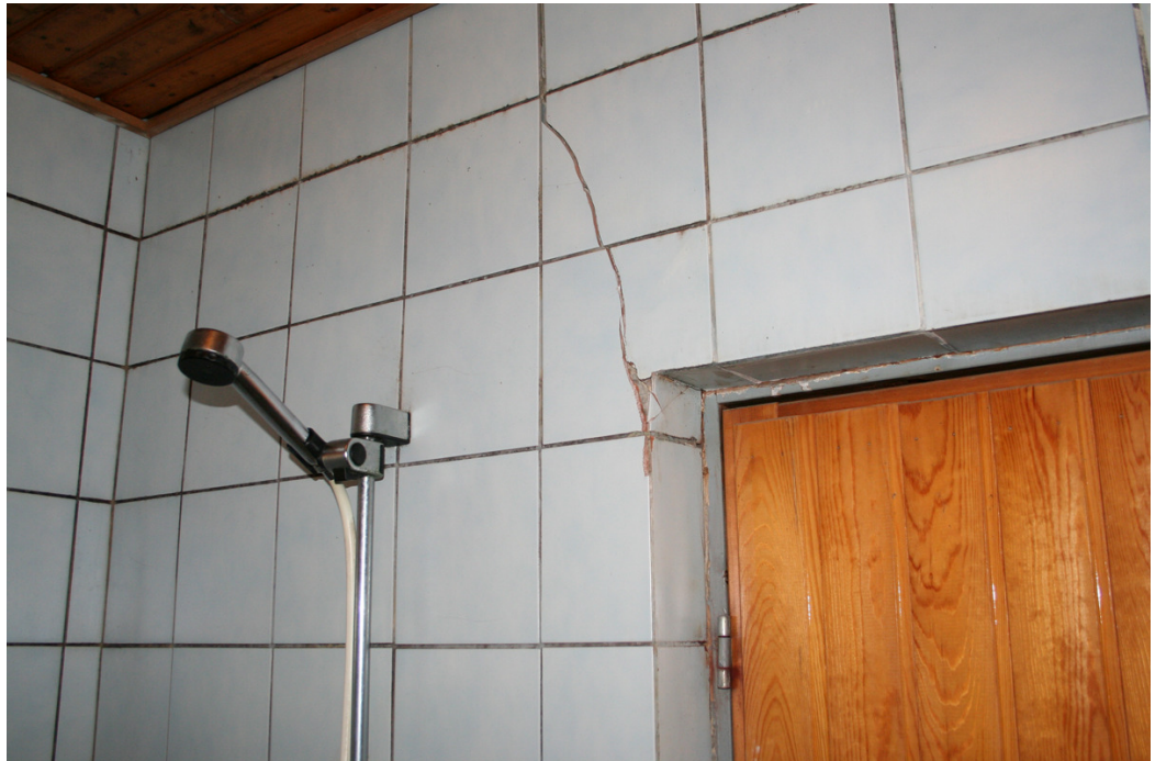
Kuva 8. Kylpyhuoneen laatoituksen halkeilu
