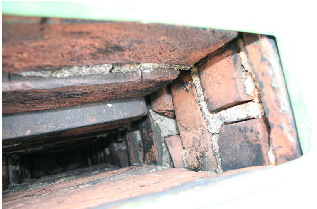
Kuva 10. Painovoimaisen ilmanvaihdon rapautunut ilmanpoistohormi
