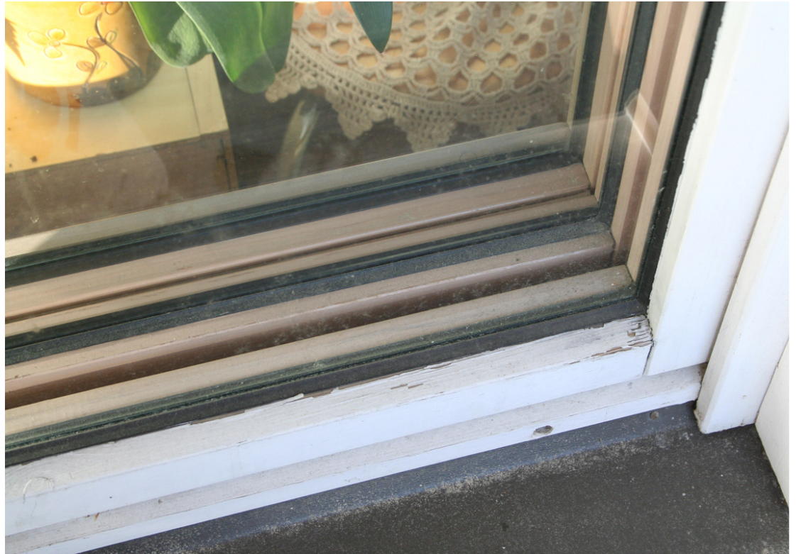
Kuva 6. Maalin hilseilyä ikkunapuitteessa
