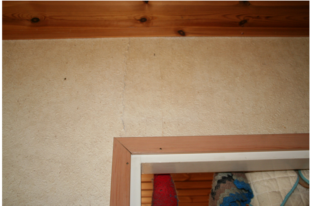
Kuva 7. Tapetoidun lastulevyseinän halkeilua
