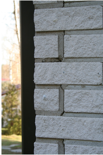
Kuva 3. Perustusten elämisestä aiheutuvaa tiiliseinän halkeilua
