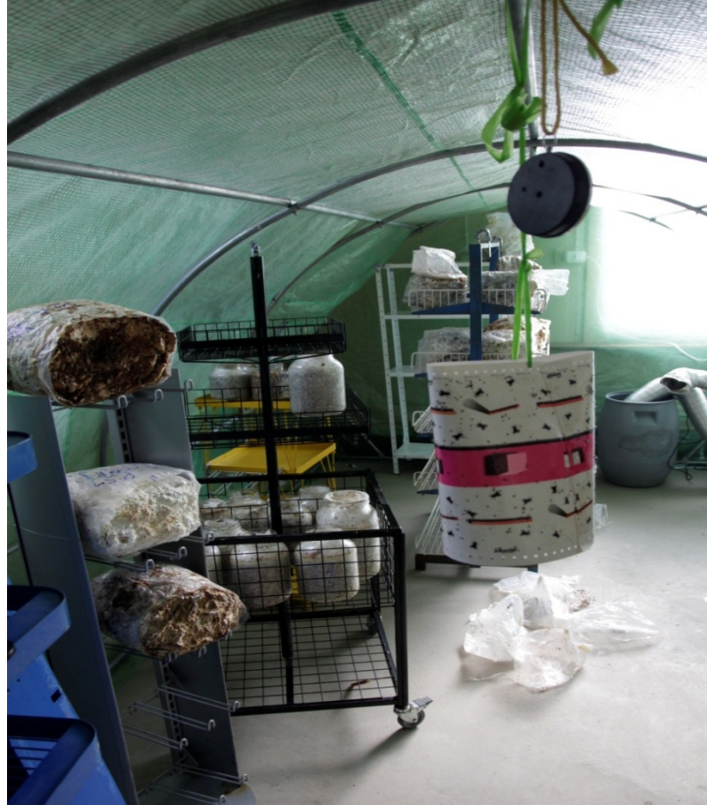
Kuva 30 Ilmanpuhallus ja -poisto asennettuna kasvatusteltassa.
