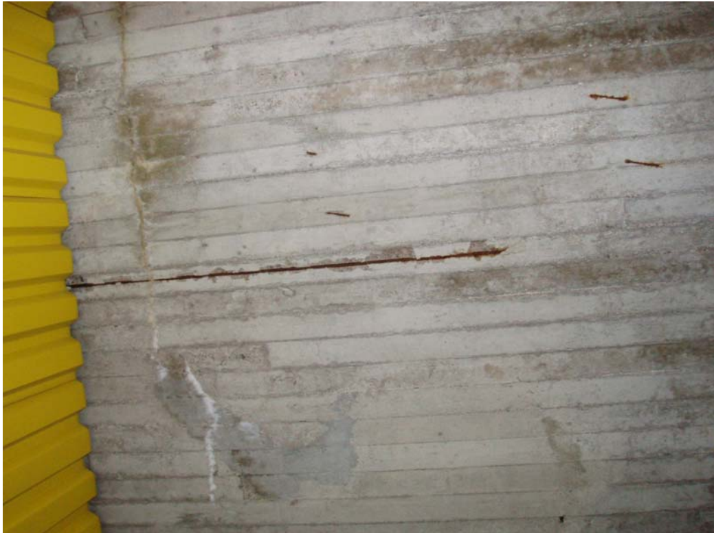
Kuva 2. sillan vauriot jatkuvat todennäköisesti myös varaston päällä
