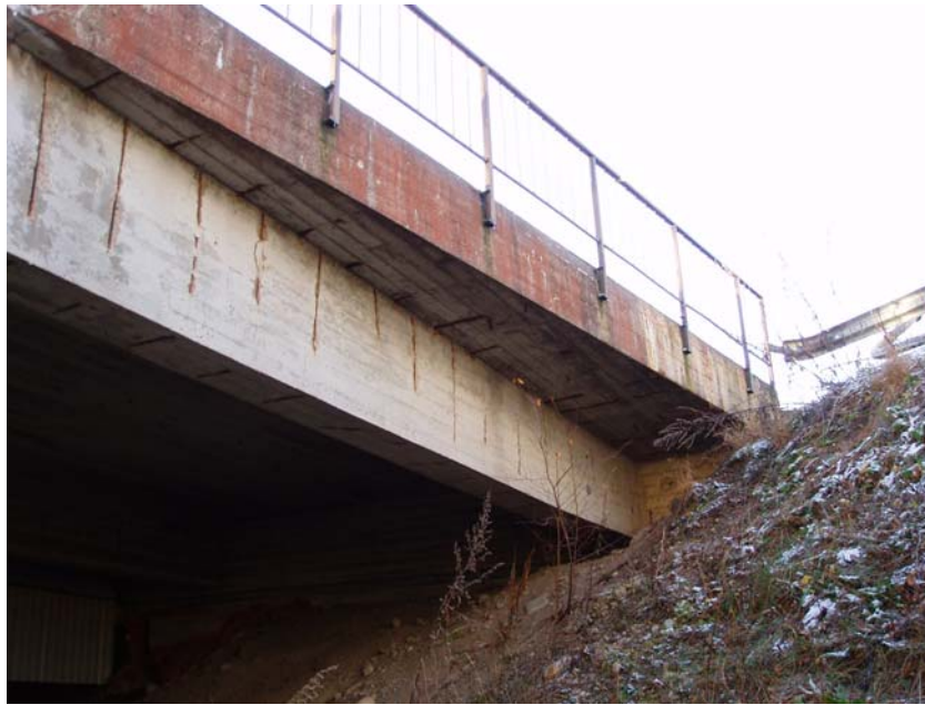
Kuva 2 Palkin terästen korroosioaurioita
