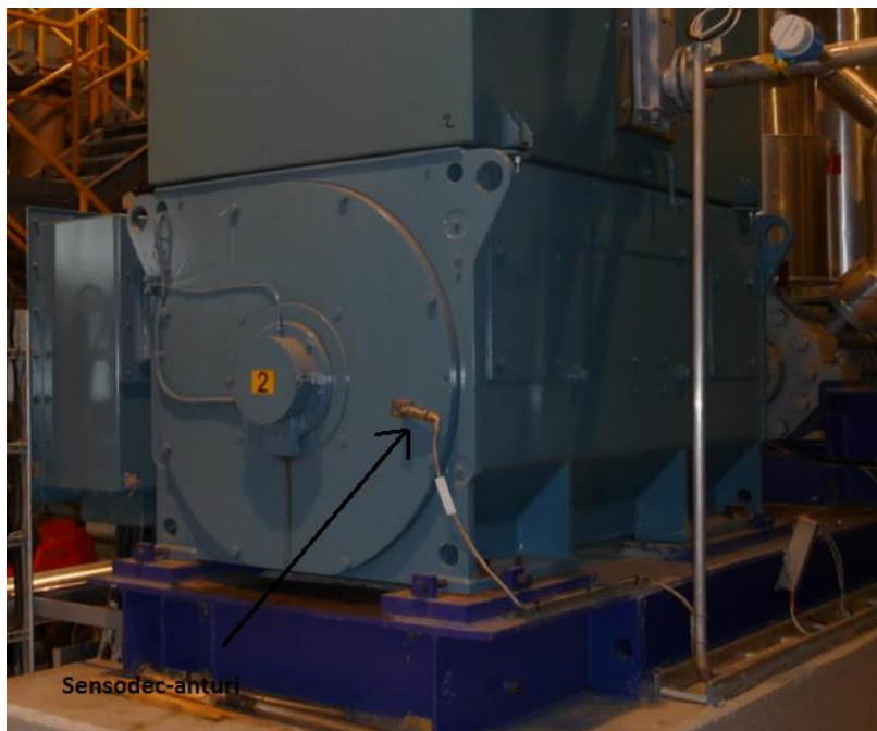
Kuva 7. Anturi, josta yhteys Sensodec-kunnonvalvontajärjestelmään
