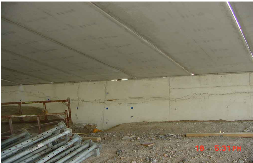
Kuva 15. Tukimuurin työsauma näkyy selvästi.
