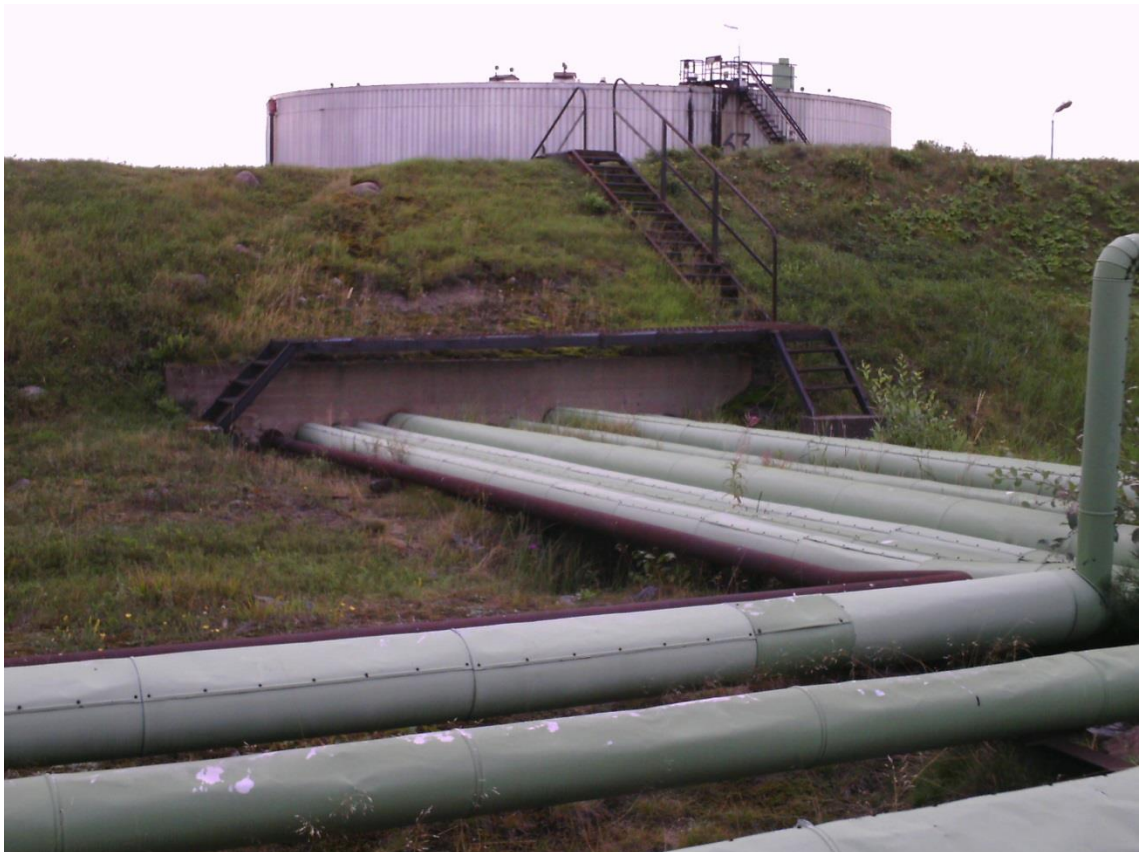
Kuva 12. Vanhan tyyppinen maavallin läpi kulkeva putkilinja on usean metrin matkalta maavallin peitossa tarkastusten ja huollon ulottumattomissa.
