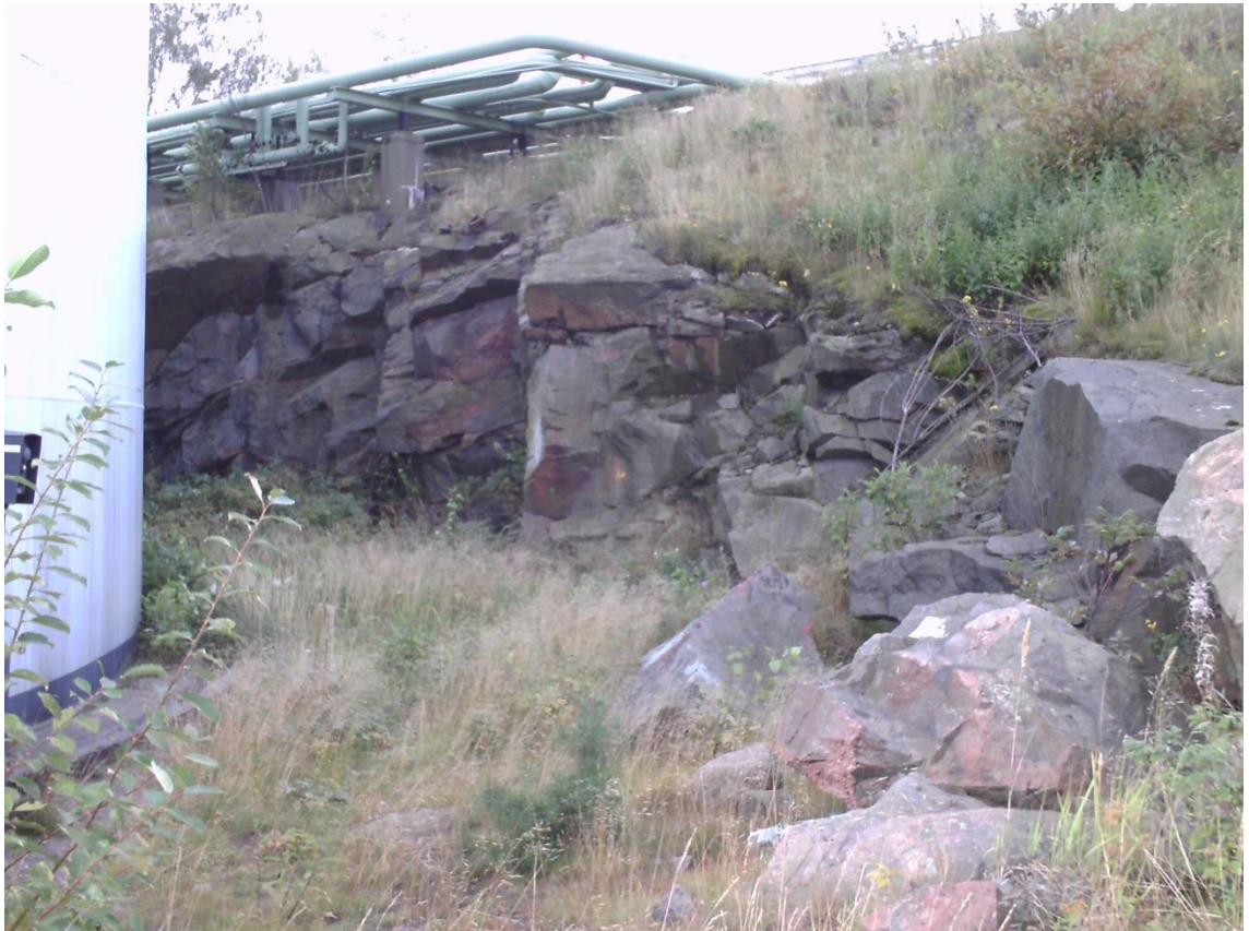
Kuva 10. Säiliöiden luoteispuolet ovat paikoin liian jyrkkiä luiskavallin tekemiseen.
