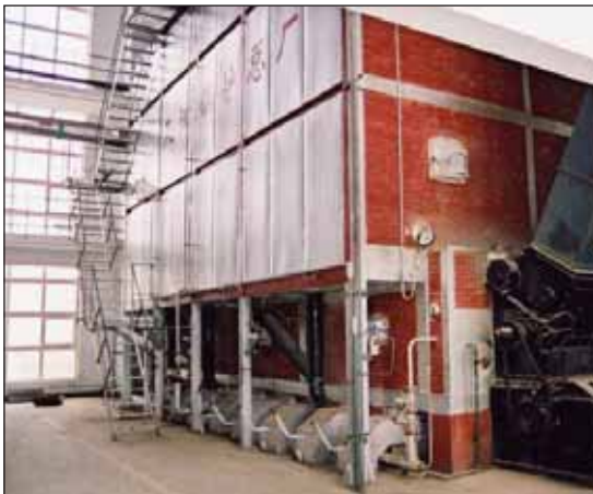
Kuva 14: Kiinteän polttoaineen 20 MW:n kattila kiinalaisessa lämpökeskuksessa (kivihili)
