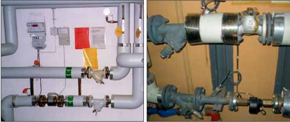
Kuva 61: Suomalaisia kaukolämmön mittauskeskuksia asennettuna
