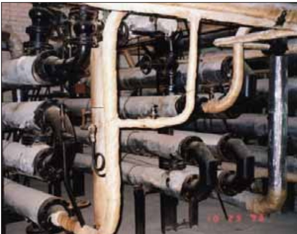
Kuva 96: Korttelilämmönjakokeskuksen käyttöveden lämmönsiirrin (Pskov, Venäjä)
