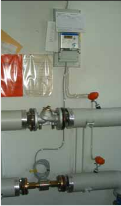
Kuva 75: Kaukolämmön mittauskeskus varustettuna virtauksen rajoittimella
