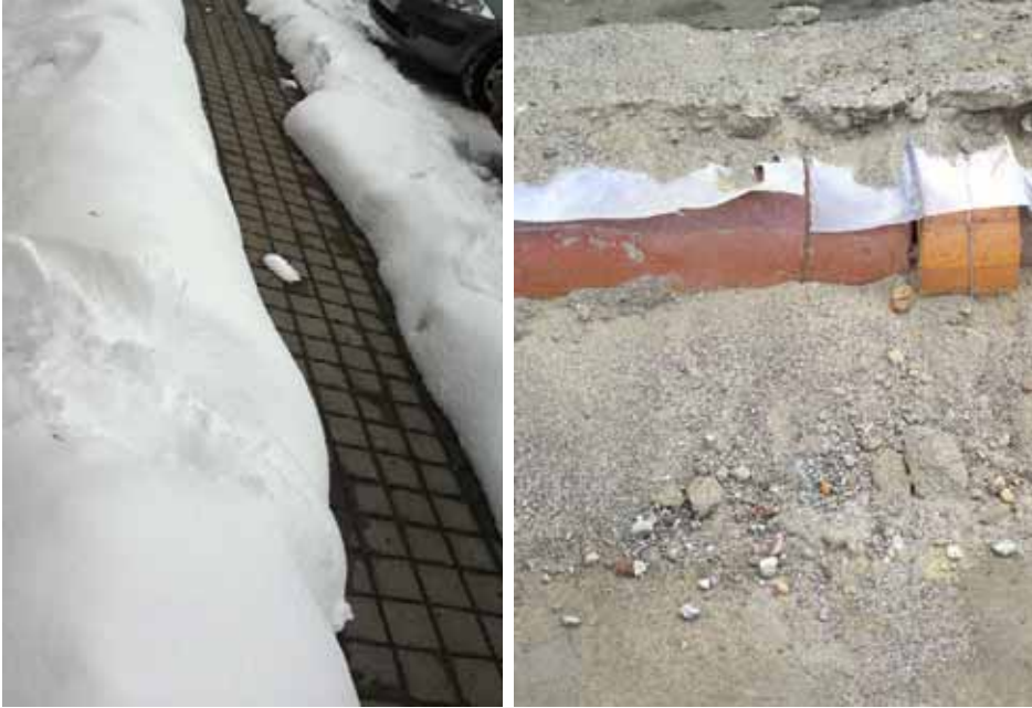
Kuva 82: Lumi sulaa kaukolämpöjohdon päältä
