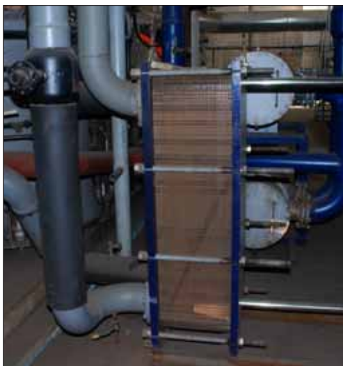
Kuva 86: Kaukolämmön lämmönsiirrin Venäläisellä lämpökeskuksella (Präsa, Venäjä)
