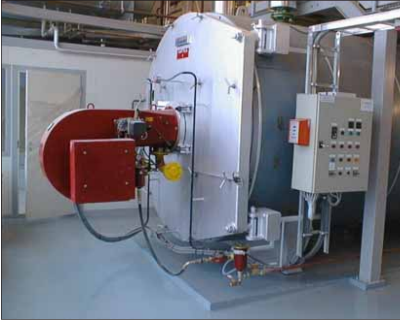
Kuva 12: Kiinteän lämpökeskuksen kattila ja yhdistetty öljy- kaasupoltin (5 MW)
