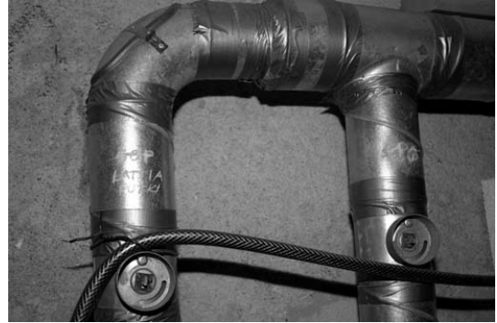
Kuva 16.5 Radonputkistoa, joka on yhdistetty yhdeksi poistokanavaksi
