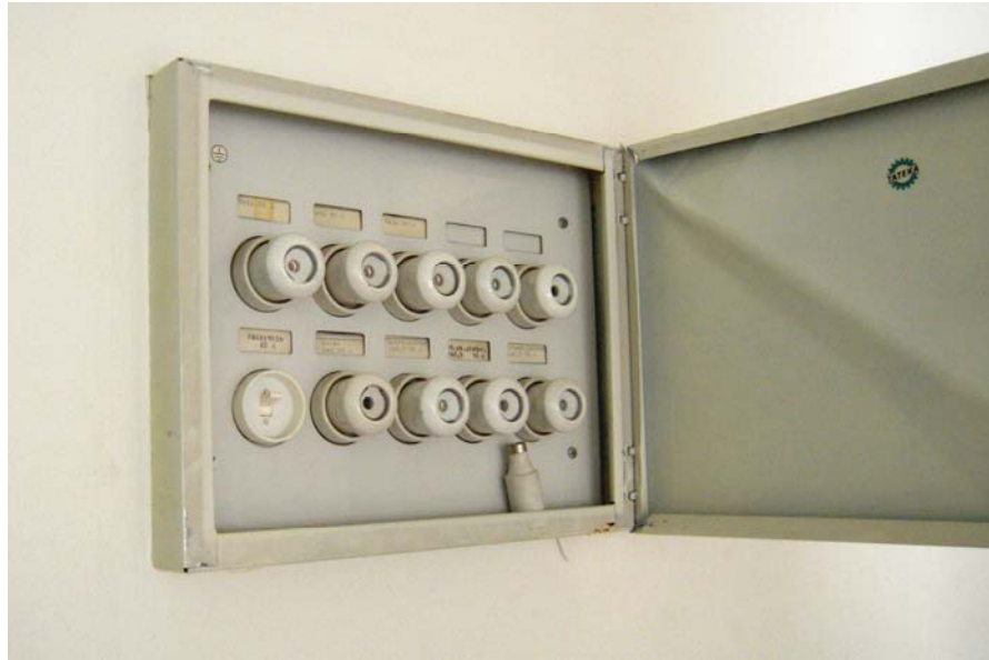
Kuva 7. Peruskorjattavan asunnon ryhmäkeskus ennen peruskorjausta.
