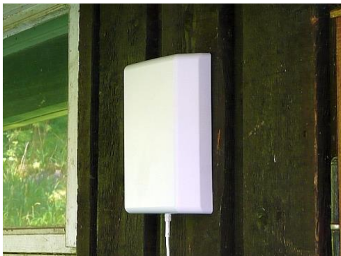
Kuva 21. Paneeliantenni talon seinässä.
