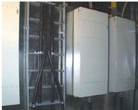
Kuva 9 Pienjänniteverkon suodattimia käytetään viestiasemien lisäksi myös matkapuhelinkeskuksien tehonsyötön suojauksessa. Kuvassa Filtro Oy:n valmistamia 4x200A:n suodattimien rivistöä. /8./
