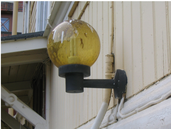
Kuva 2. Seinävalaisin toiselta sivulta
