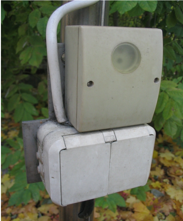
Kuva 6. Hämäreäkytkin ja ulkopistorasia
