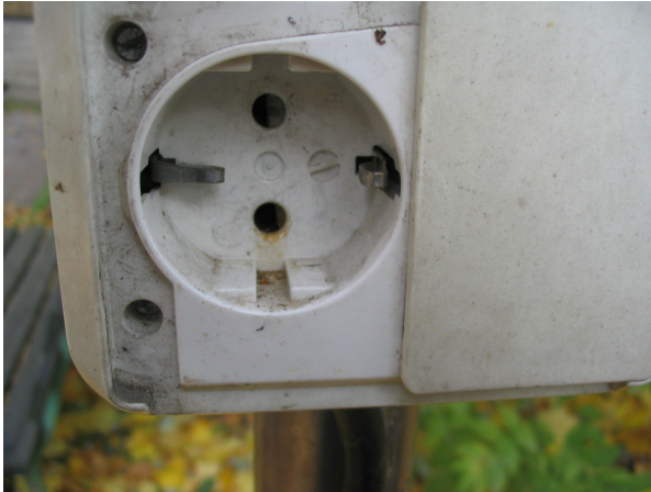
Kuva 12. Sulut ruostunut auki
