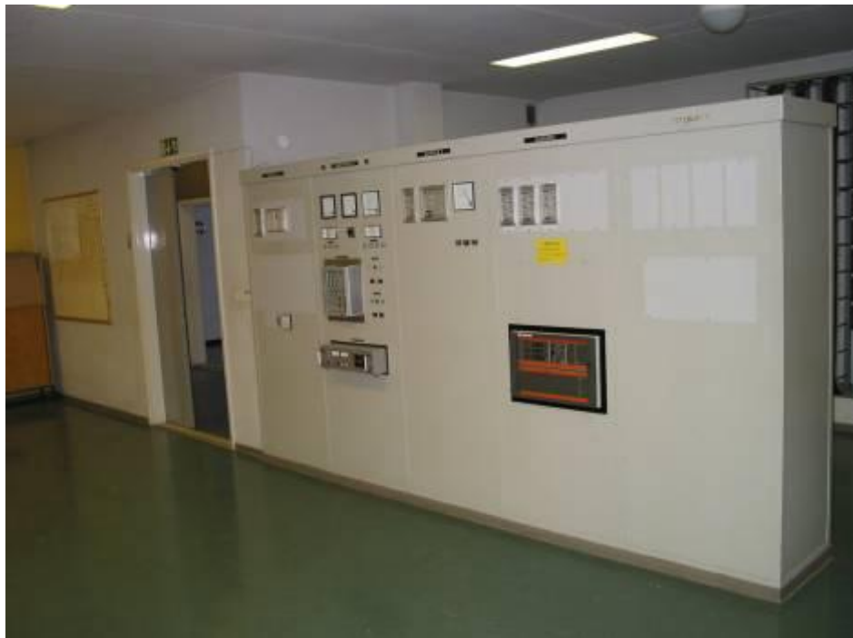
Kuva 11. Kalevan sähköaseman 110 kV:n reletaulu
