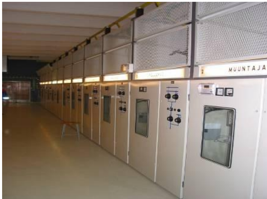
Kuva 10. Kalevan sähköaseman vanha 20kV kojeisto
