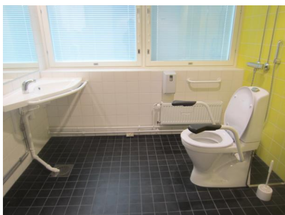
Image 45: The accessible toilet (Jaakkonen, 2015)
