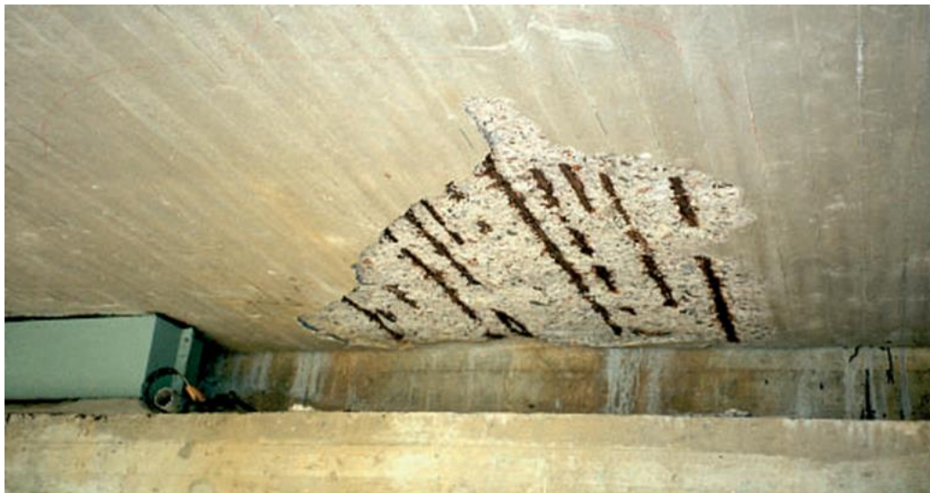
Kuva 6. Teräskorroosion irrottama betonipeite (Laitinen & Yli-Pentti, 2014).
