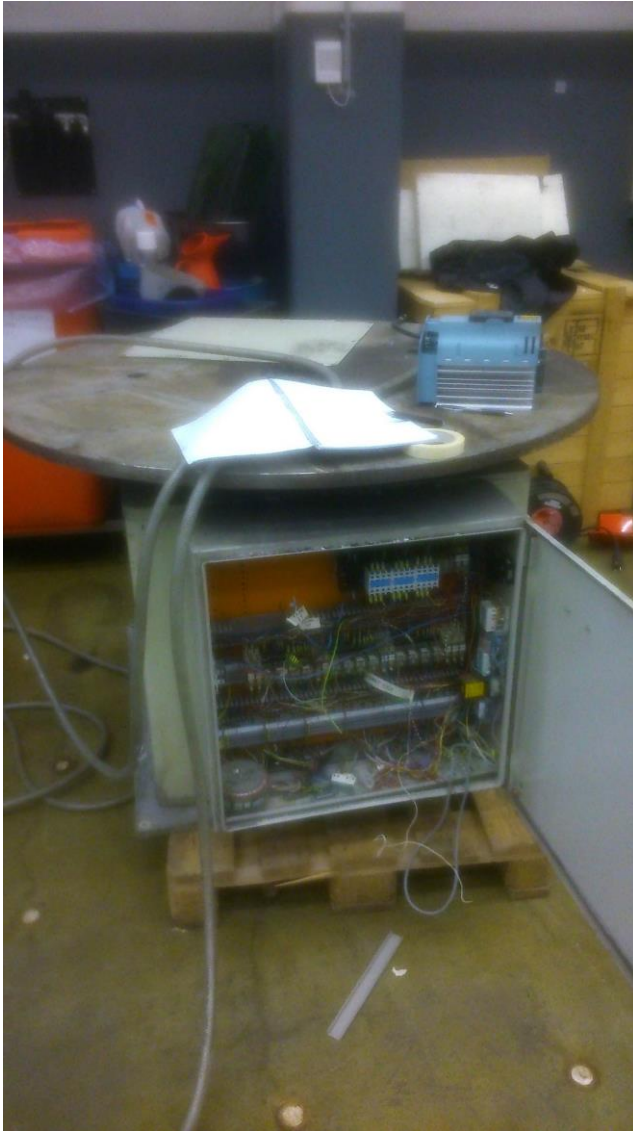
KUVA 7. Pyöröpöytä ja sähkökaappi
