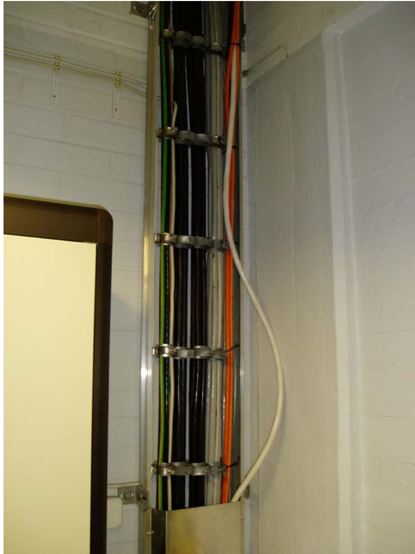
Kuva 8 TKK:n sähkölaitehuone 1:n pystykaapelihihly
