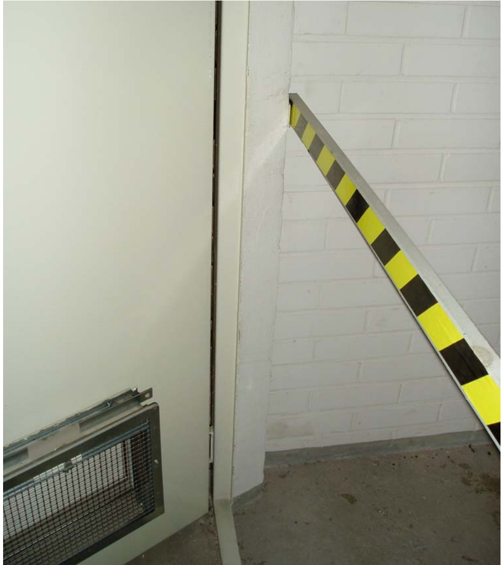
Kuva 7 TTK:n omakäyttömuuntajan tilan ovi
