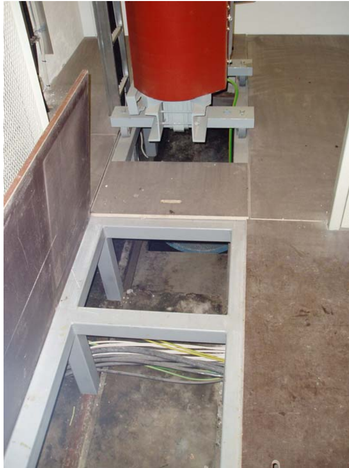
Kuva 15 TKF:n omakäyttömuuntajan kosketussuojauksen puute
