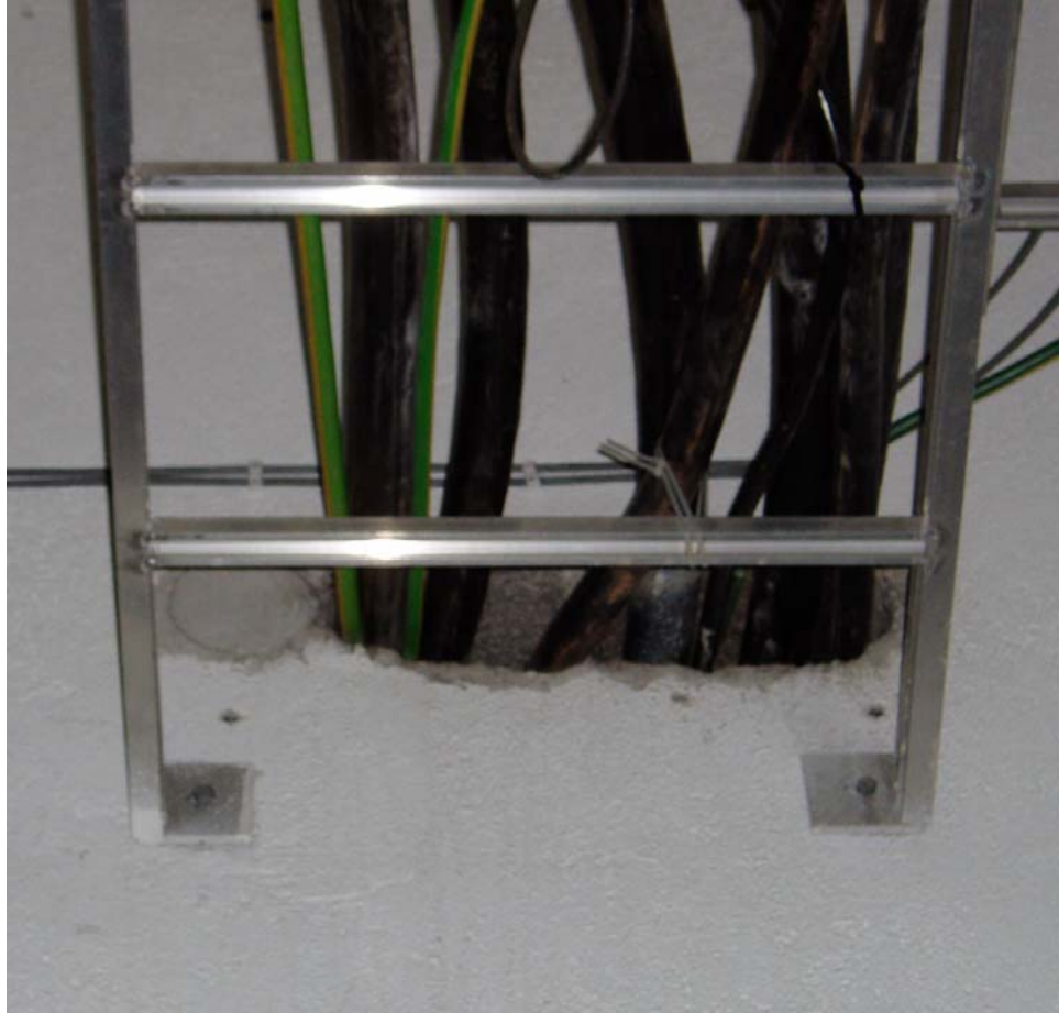
Kuva 9 TKT:n 5 kV kojeistotilan sähköläpivienti
