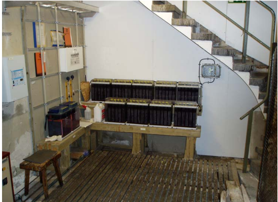
Kuva 14 TKF:n 5 kV kojeistotilan alakerrassa sijaitseva akusto
