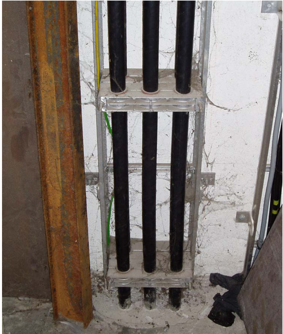
Kuva 10 TKT:n muuntajatilán 5 kV kaapeleiden lattialäpivienti
