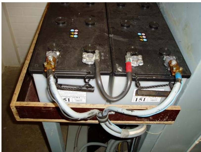
Kuva 6 Keskiputouksen voimalaitoksen varavoimakonetilan akusto
