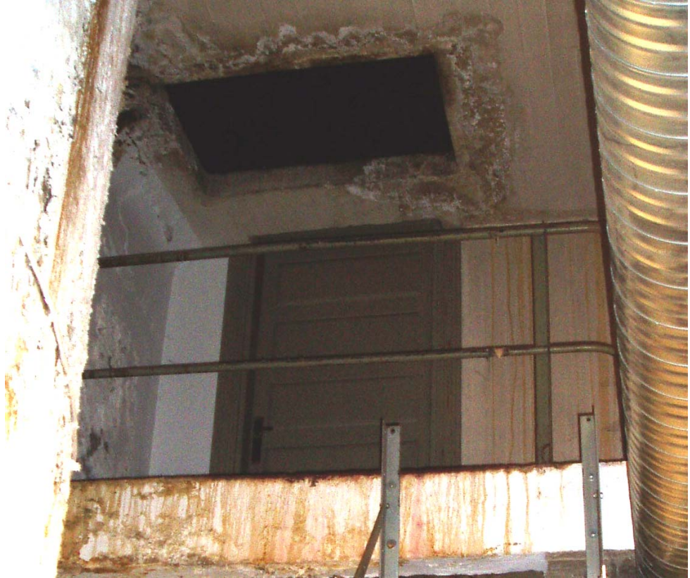
Kuva 11 TKF:n 5 kV kojeistotilan keskikerroksen puutteellinen varauloskäynti
