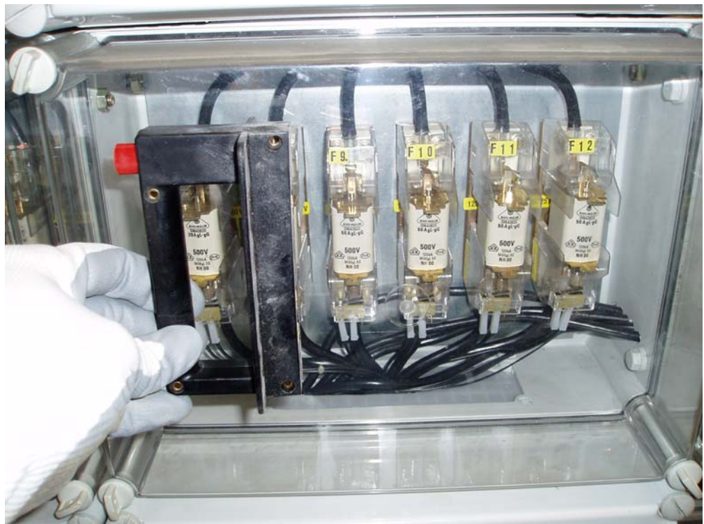
Kuva 13 TKF:n 5 kV kojeistotilan alakerran sulakkeenvaihtotyökalu
