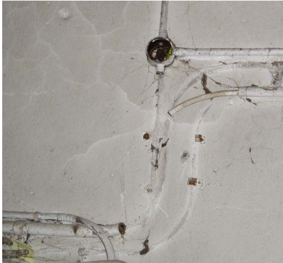
Kuva 16 TKF:n käytöstä poistettu kaapeli ja avonainen jakorasia
