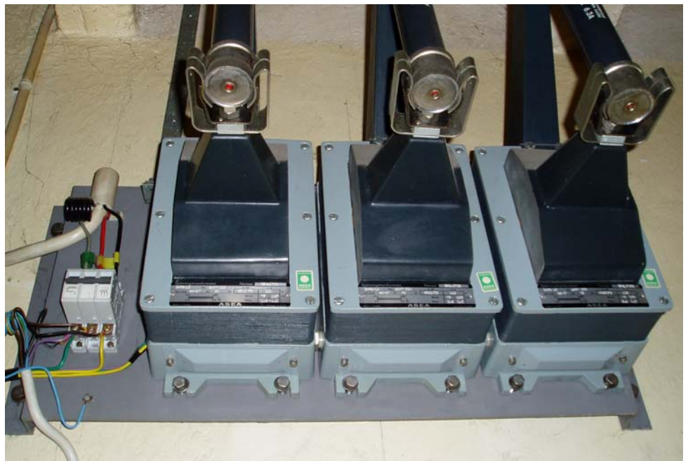
Kuva 12 TKF:n 5 kV kojeistotilan keskikerroksen jännitteenmittauslaitteiston suojaamattomat osat
