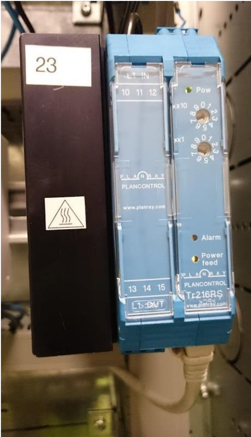
KUVA 15. Tr216-tehoyksikkö toiminnassa. Pow-valo kertoo laitteen saavan käyttöjännitteen ohjausyksiköltä. Alarm-valo kertoo punaisella valolla mahdollisesta hälytyksestä. Power feed –valo ilmaisee lämmityskaapelin olevan toiminnassa.
