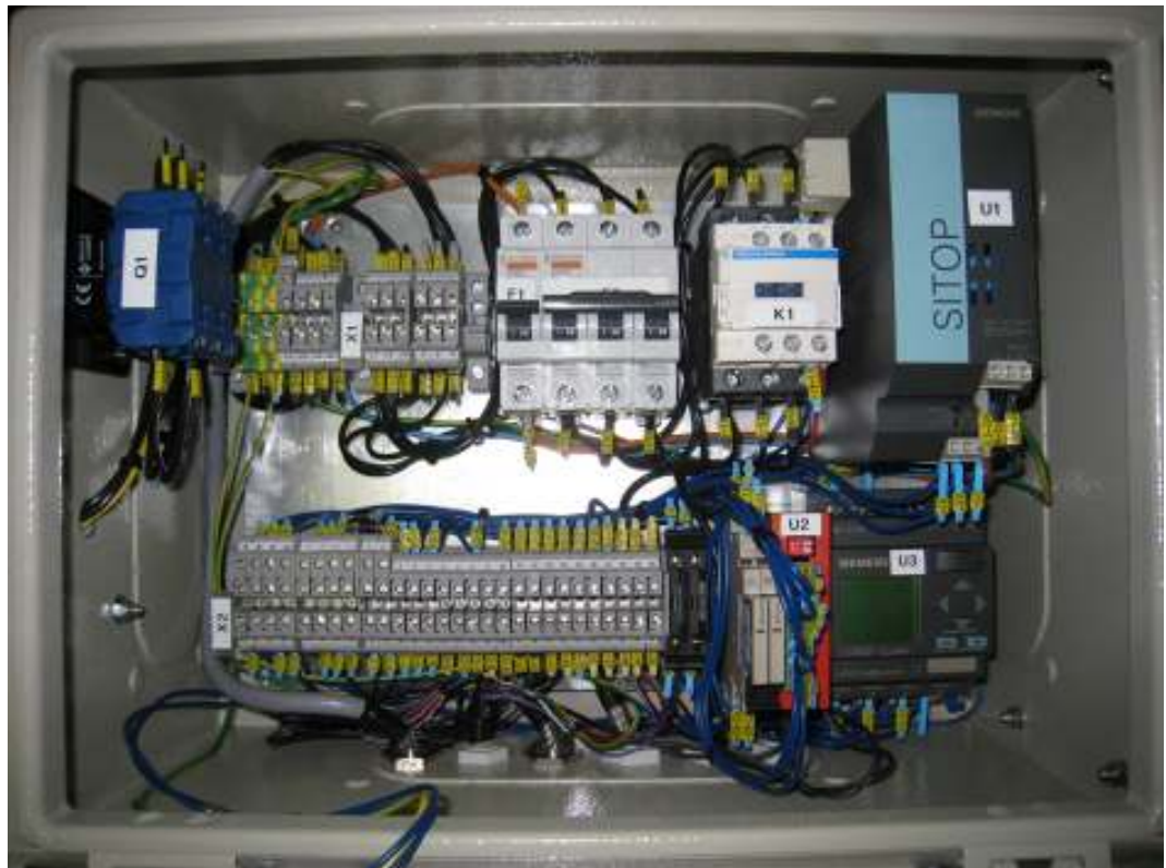
Kuva 16 Kytkentäkotelo, valmiit kytkennät
