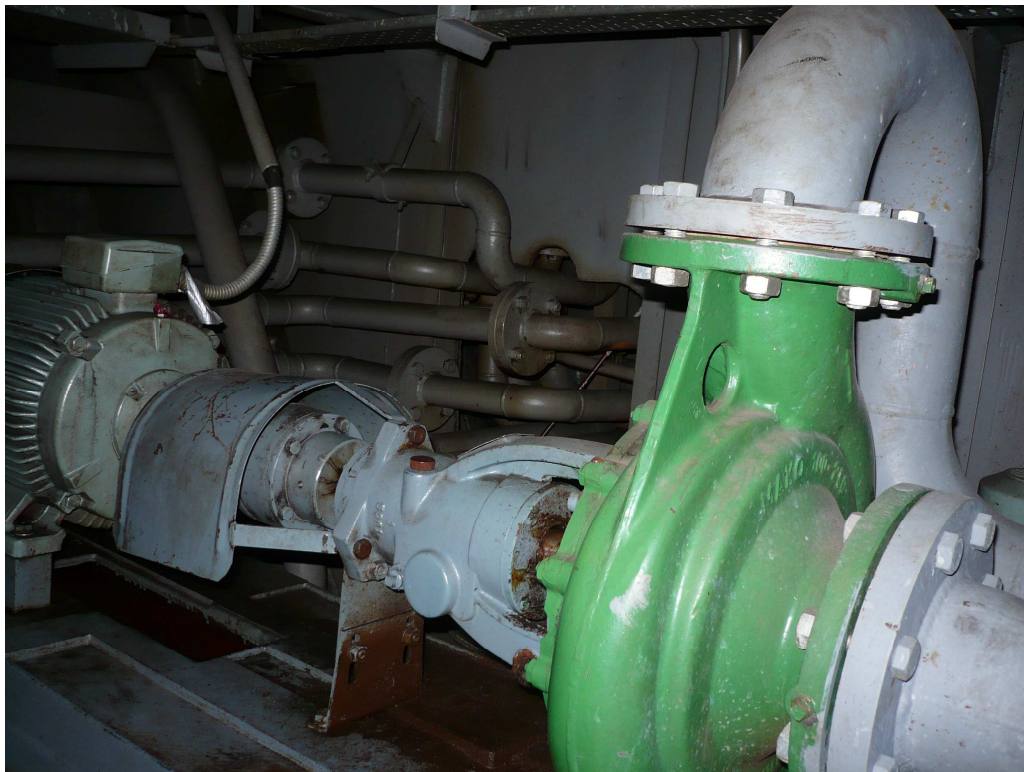
Kuva 9. Pääkoneen Stand by -HT pumppu
