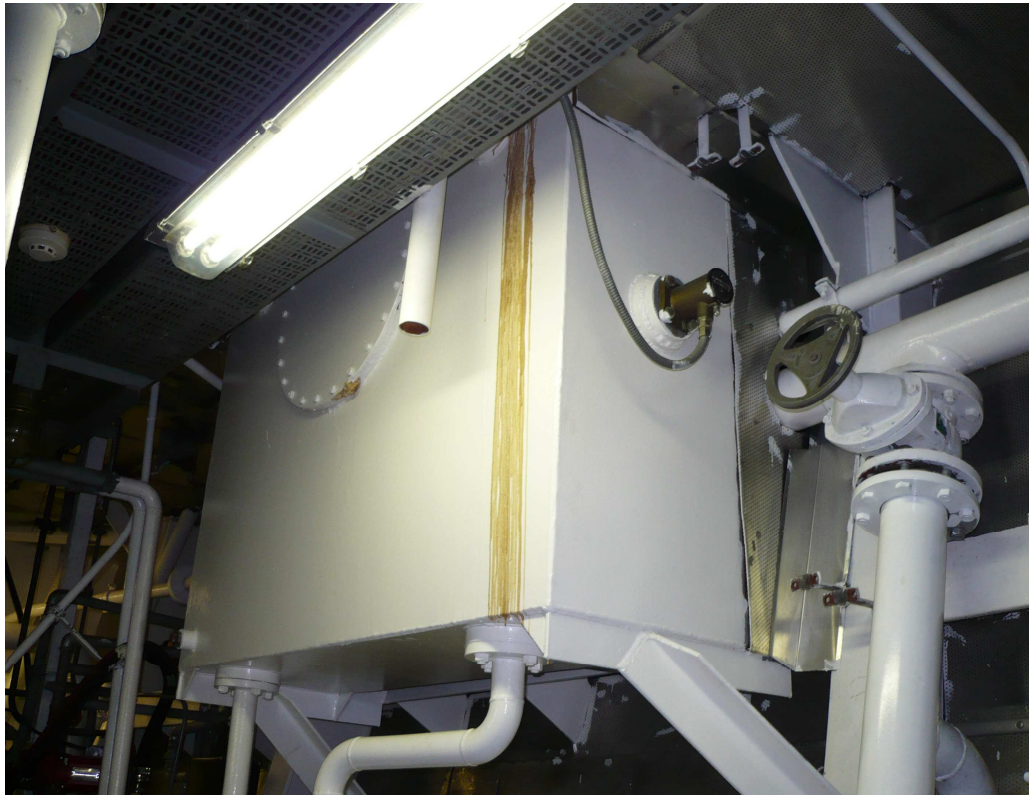
Kuva 10. Pääkoneen HT veden iso paisuntasäiliö konehuoneessa
