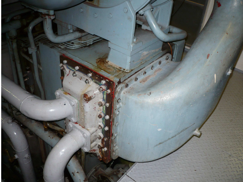
Kuva 6. Pääkoneen huuhteluilman jäähdytin
