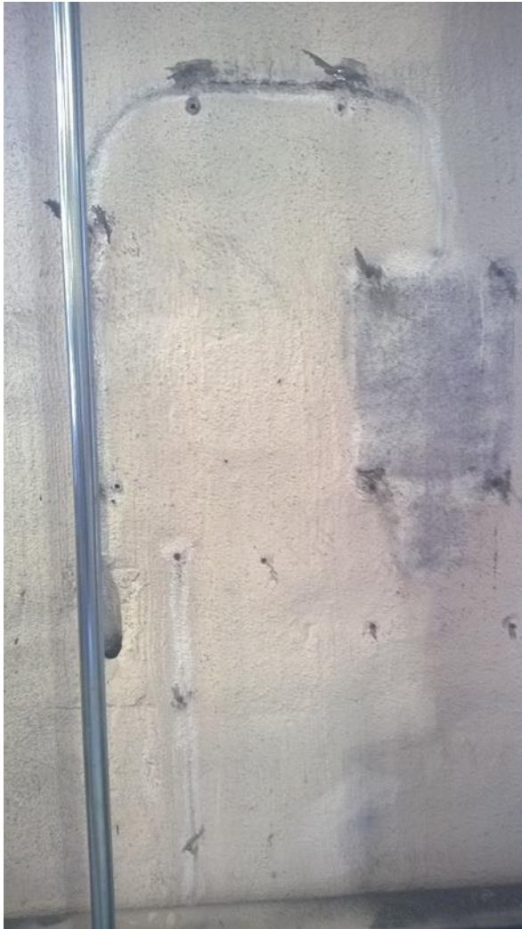
Kuva 16. Esimerkki seinältä poistetuista sähkökaapeleista
