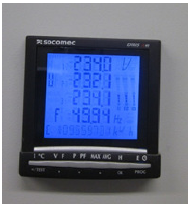
Kuva 13. Socomed Diris A40 sähkökeskuksessa
