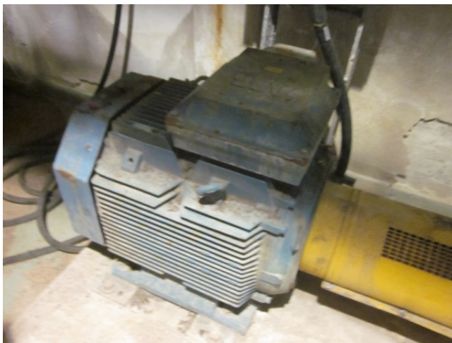
Kuva 15. Suolanpoiston kemiallisen veden pumppu
