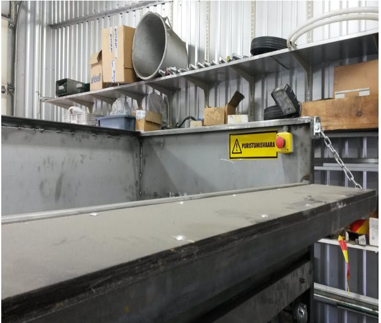
KUVA 5. Puhallusvillakoneen hätäpysäytin sekä varoitustarra.
